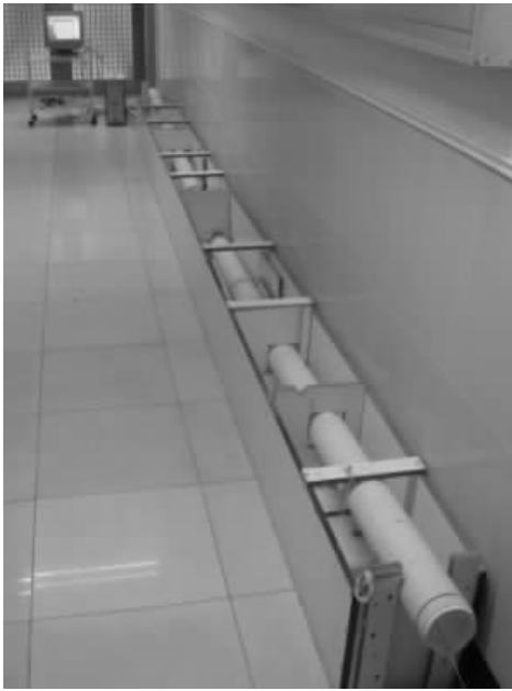
图 10 实测管道及实验场景
